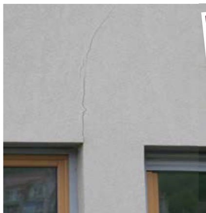
Značilne razpoke na nekaj let stari fasadi so posledica neakovostno opravljenega dela – izvajalci niso križno armirali fasade pri vogalih oken.
