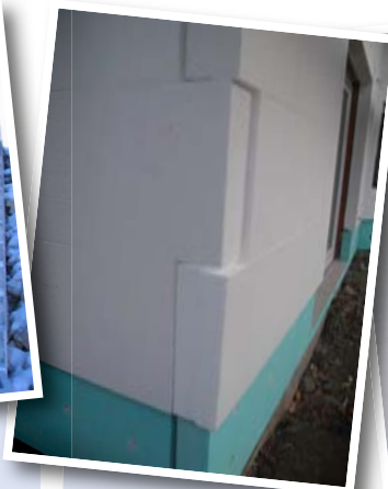
Nepopolni vogal in velike režezstikov niso odraz mojstra, stavba bo tu izgubljala toploto.
