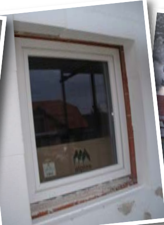
Slaba rešitev okrog okna, kjer je na špaleti toplotni most.
