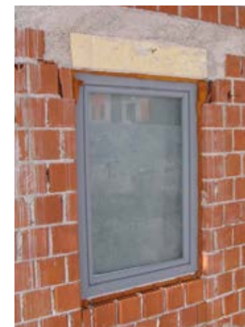
Ker je okno zamaknjeno za 5 cm od zunanje linije zidu, bo imel investitor velike težave s plesnijo na notranjih špaletah, saj ni prostora za montažo dovolj debele toplotne izolacije v špaleti.
