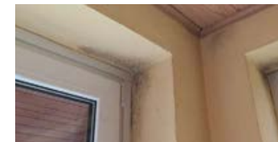
Plesen je – tako kot vročina pri človeku – nedvoumen dokaz toplotnih mostov na ovoju stavbe.
