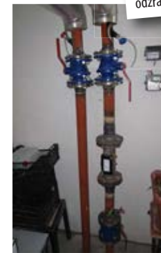
Podpostaja daljinskega ogrevanja v kleti večstanovanjske stavbe s kalorimetrom in z zaslonom za odčitavanje porabljene toplote za celotno stavbo. Na radiatorjih v stanovanju so delilniki toplote, ki beležijo porabo na vsakem radiatorju posebej.
