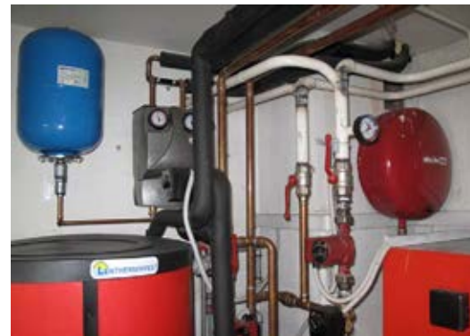
Pogost sestav naprav v kurilnici: kotel na polena, bojler sanitarne vode in hranilnik tople vode. Vanj se shranjuje tudi toplota iz sprejemnikov sončne energije (SSE).
