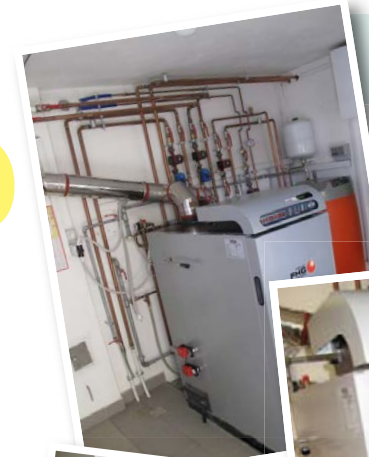
Pirolizni kotel na polena z močjo 30 kW.
