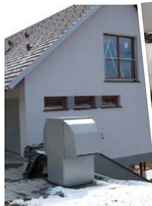
Kompaktna TČ zrak-voda z grelnim številom 3,5 stoji ob hiši, poleg kurilnice.
