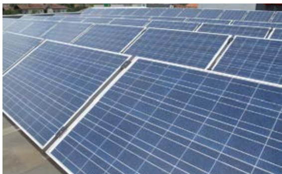
Paneli na ravni strehi potrebujejo 20 m 2 na kW inštalirane moči.
