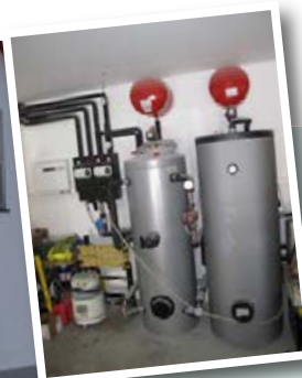
V kurilnici so z desne proti levi: 400-litrski bojler za sanitarno vodo, 300-litrski zalogovnik za TČ, set za hlajenje in ogrevanje ter omarica z avtomatiko.
