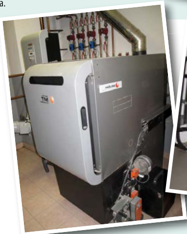
V ospredju je dovod primarnega in sekundarnega zraka v kurišče kotla na sekance (50 kW), zadaj razvodne cevi, ventili, črpalke ...
