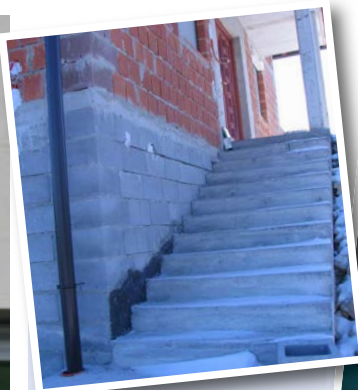
Zunanje stopnice, vpete v obodni zid, bodo povzročile enake težave kot neizoliran balkon. S prenosom hladu prek zidu v notranjost bo tu kondenzirala notranja vlaga, tej sledi plesen.
