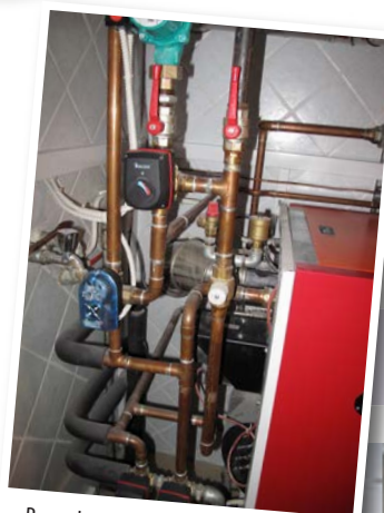
Razvodni regulacijski sistem dveh kotlov: spodaj je kotel na polena, nad njim kotel na kurilno olje.
