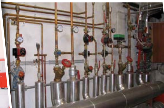
Vzorno narejen razvodni sistem kotla na žaganje z močjo 220 kW. Del cevi ni izoliran, saj kurilnico uporabljajo tudi za sušenje oblačil.
