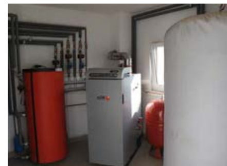
Klasični elementi kurilnice na polena so bojler sanitarne vode, kotel, tlačna posoda, hranilnik tople vode in razvodni regulacijski sistem.
