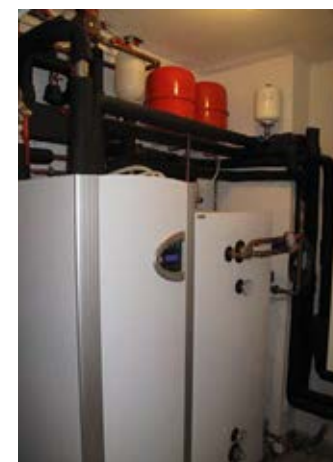
Toplotna črpalka z močjo 11 kW (v njej je tudi 160-litrski bojler), zadaj 500-litrski hranilnik tople vode.
