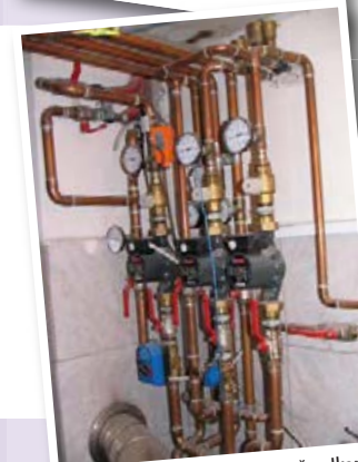
Razvodni regulacijski sistem s črpalkami, ventili, merilnimi instrumenti, odzračevalnimi lončki itd.
