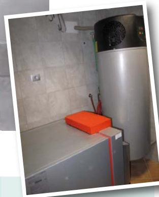
Kondenzator in hranilnik toplote sta v kurilnici (zadaj).
