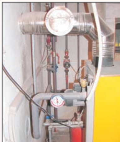
Za kotlom prevladujejo cevi, merilniki in ventili
