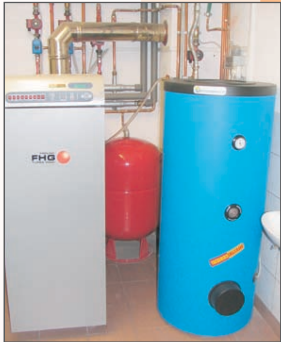
Kotel CK na polena in solarni bojler skrbita za toplotno ugodje stanovalcev
