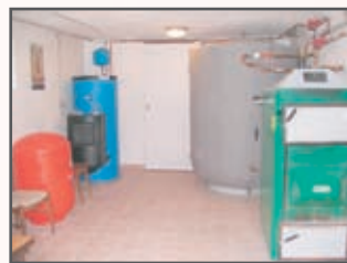
»Panoramski« pogled na kurilnico. Na levi je ekspanzijska posoda, sledi toplotna črpalka, hranilnik tople vode in kotel.
