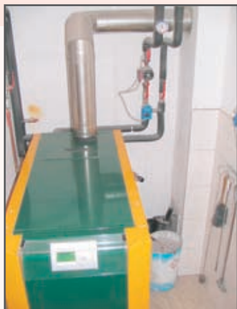
Kotel na polena v celoti zadosti energetskim potrebam stanovanjskega in vseh pomožnih objektov domačije
