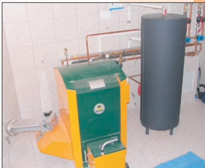
Levo polž za dovod pelet, kotel, desno bojler za sanitarno vodo
