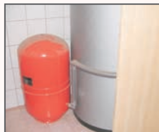
Dva hranilnika tople vode izven kurilnice sta zaščiteni z leseno steno
