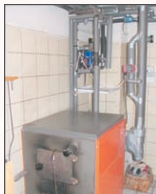
Navaden kotel na polena je z toplotnim izmenjevalcem povezan s solarnim bojlerjem
