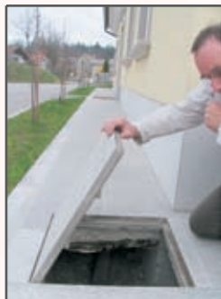
Prezračevalni jašek pod pločnikom za osuševanje temeljev brez hidroizolacije
