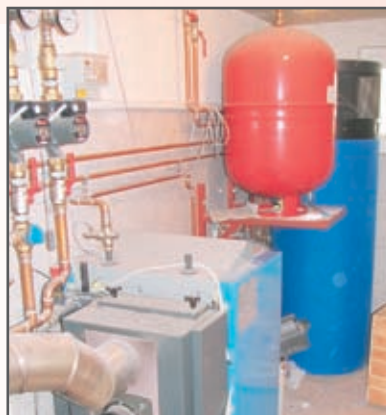
Kotel CK na polena, ekspanzijska posoda in toplotna črpalka
