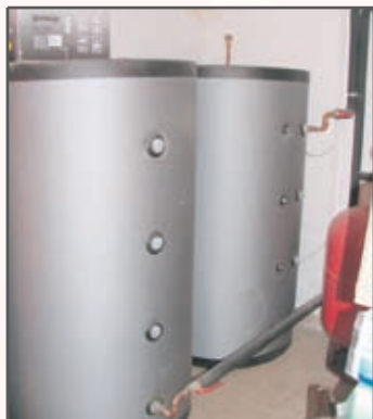
Hranilnika tople vode segrevata sanitarno vodo tudi poleti, ko se kotel zakuri na 5 – 7 dni
