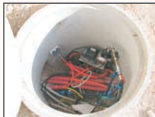
Jašek s črpalko in ventili za izrabo deževnice
