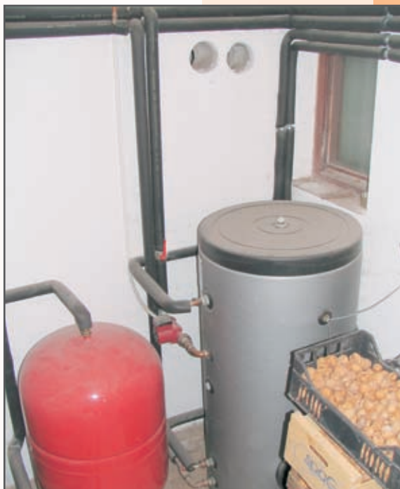
Levo 200 litrska ekspanzijska posoda, desno bojler za sanitarno vodo
