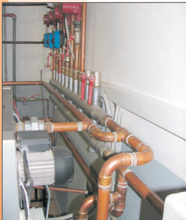
Ozadje kotla z razvodnimi cevi, ventili, črpalkami,...
