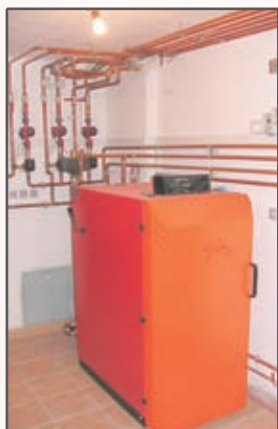
Kotel in cevni sistem za povezave
