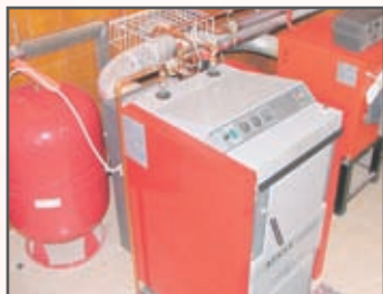
Pirolizni kotel in ekspanzijska posoda v ospredju, zadaj kotel na nafto (miruje od leta 2004)
