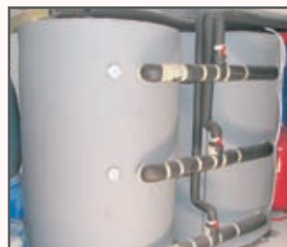
Dva hranilnika tople vode v kleti sta bila narejena po naročilu
