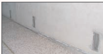
Prezračevana fasada (vidijo se zračniki) eliminira vse toplotne mostove
