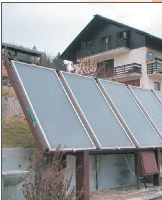
Postavitev SSE omogoča enostavno vzdrževanje in termosifonski dvig tople vode
