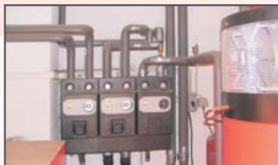
Črpalke poskrbijo za razvod tople vode
