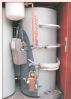
Hranilnik tople vode ima spodaj prenosnik toplote za pripravo sanitarne vode, v sredini pa baterijo za krmiljenje
