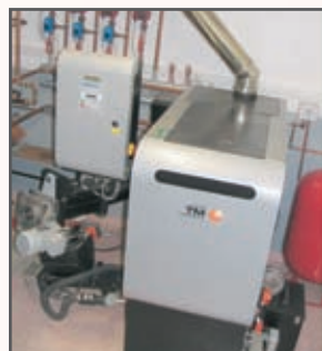
Kotel na sekance, levo komandna omarica, pod njo del polža, desno ekspanzijska posoda
