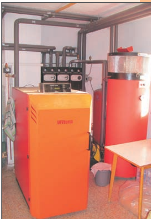
Kotel na polena in toplotna črpalka
