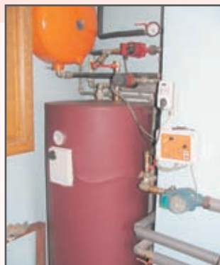
Solarni bojler, ekspanzijska posoda in cevne povezave
