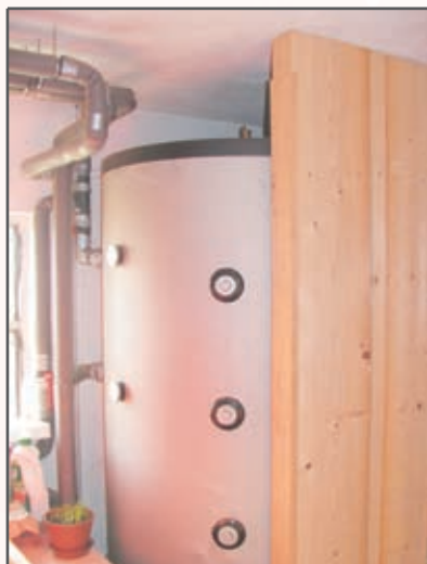
Zaščita hranilnika tople vode z leseno steno
