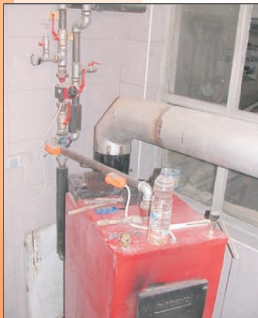
Kotel na sekance, dimnik, ventili in črpalke
