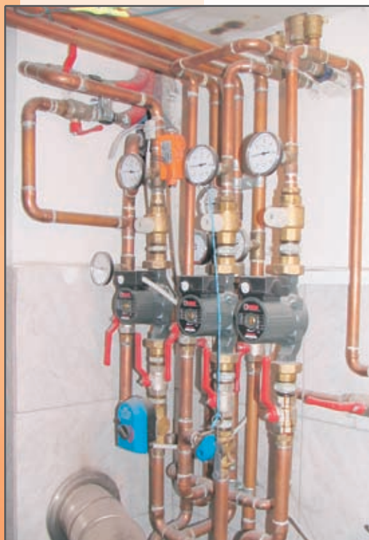
Cevni razvod z merilniki, ventili in črpalkami
