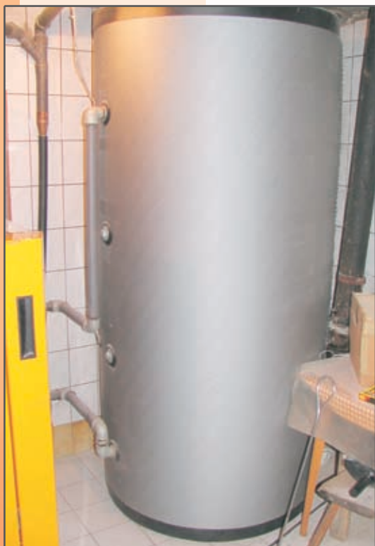
1500 l hranilnik tople vode še ne omogoča pripravo sanitarne vode
