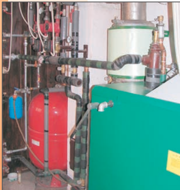
Kotel, ekonomizator, razdelilni sistem, ekspanzijska posoda in »oblečen« hranilnik tople vode
