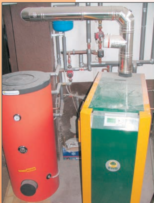
Kotel na polena in bojler za sanitarno vodo
