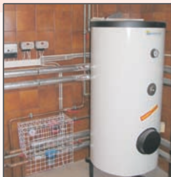
Poleg 300 l. solarnega bojlerja je (za mrežico) montiran mehčalec vode (prepreči kristalizacijo vodnega kamna)
