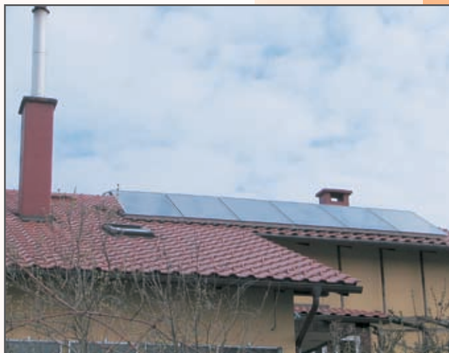
Sprejemniki sončne energije za vso toplo sanitarno vodo in 30% ogrevanja prostorov
