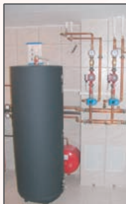
Bojler za sanitarno vodo in cevne povezave
