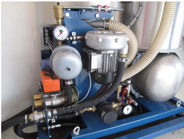
Detalj kogeneracije s Stirlingovim motorjem na pelete, izpostavljena je enota za proizvodnjo elektrike.
