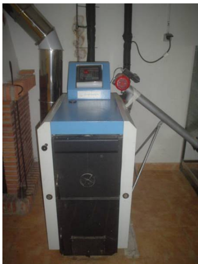
Slika 7. Boiler za biomaso, ki se uporablja v javnih zgradbah (BP5), Jaén (Spain)
