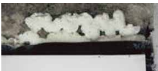
Mavčna plošča je bila tako vgrajena v rob okna, da se je okenski okvir poškodoval.
