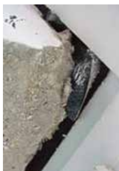
Špaleta ni obdelana, tesnilni trak nepravilno nalepljen.
