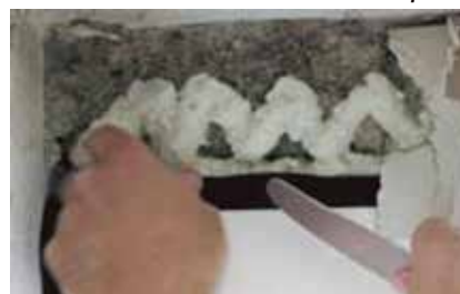
Nepravilno tesnjenje s tesnilnim trakom in tesnilno peno.
