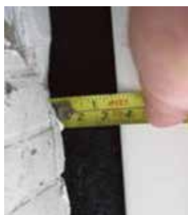
Fuga med špaletjo in oknom prevelika.
