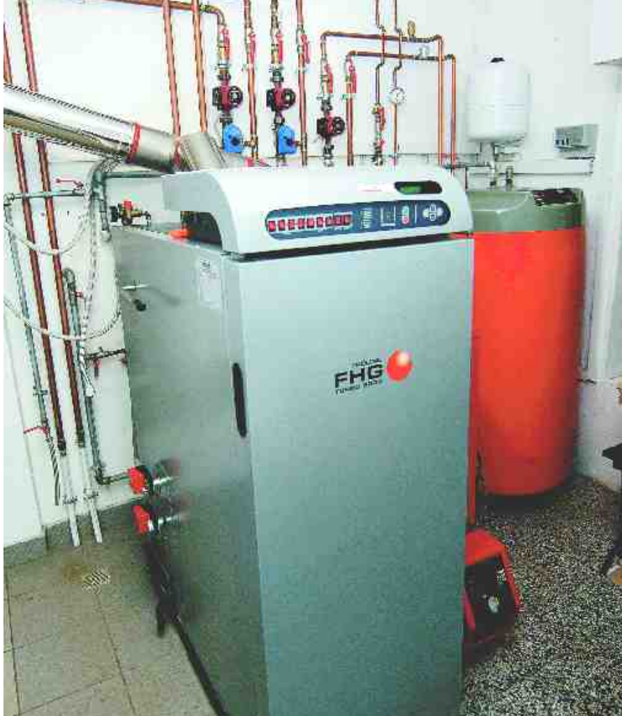
V NOVI PIROLIZNI PEČI NA POLENA POKURIJO PRIBLIŽNO ŠESTKRAT MANJ DRV KOT PRED KORENITO OBNOVO HIŠE.
