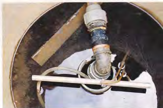
V razdalji 15 metrov sta ob hiši dve vrtini za črpanje vode iz podtalnice in vračanje za nekaj stopinj hladnejše vode v podtalnico.
